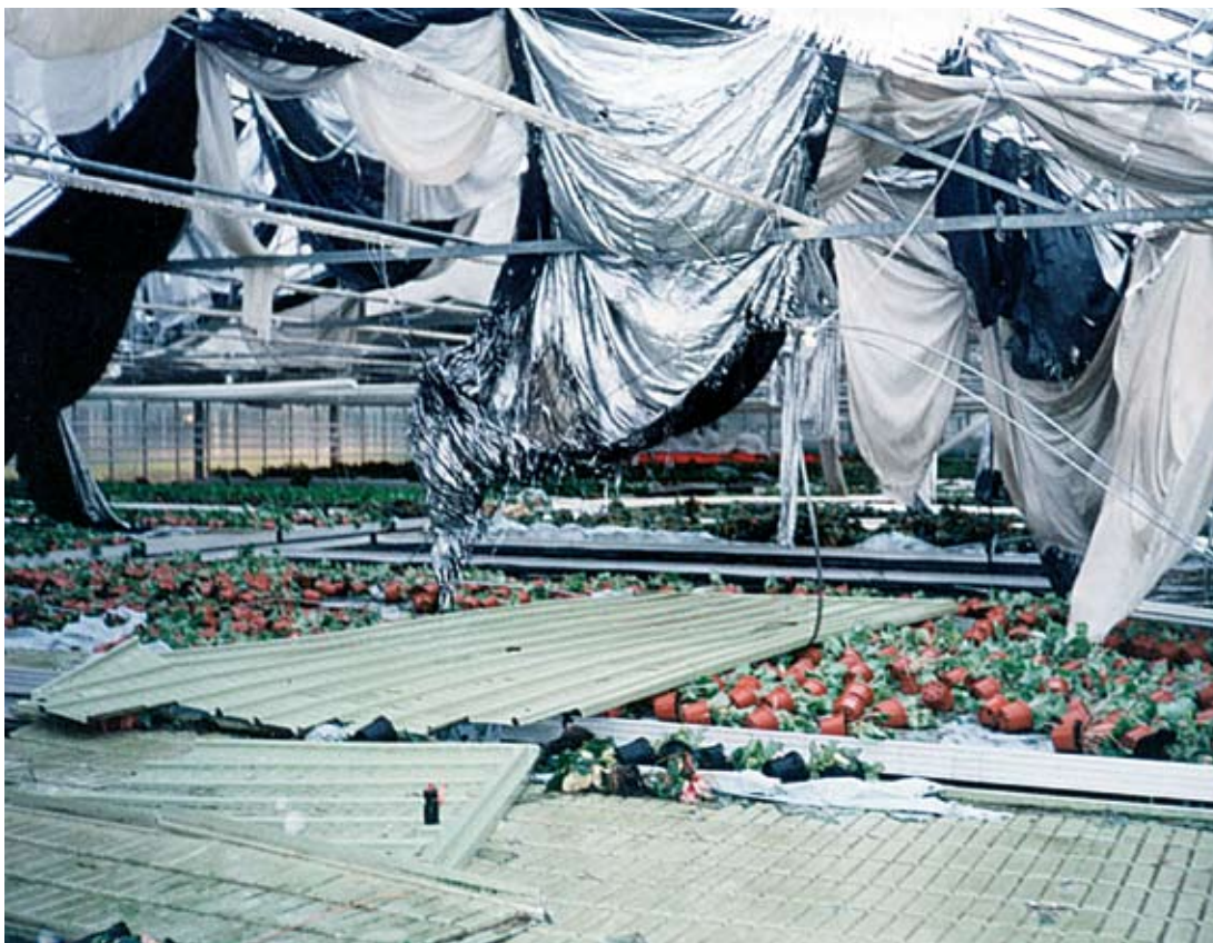
Væksthuse er udsatte bygningsværker, når storme og orkaner raser i Danmark
